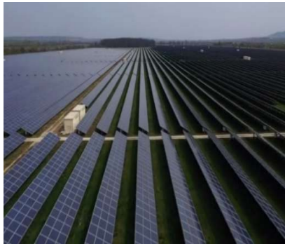
Photographie du parc photovoltaïque "Karad" - Bulgarie
