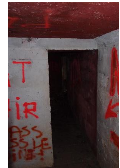
Intérieur d'un blockhaus favorable pour l'hibernation de certaines espèces de chauves-souris par exemple le Petit rhinolophe
