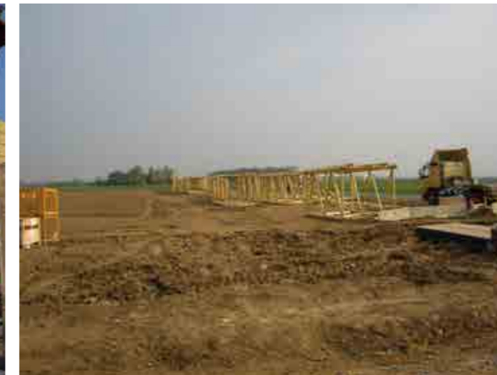
Photographie 15 : Eléments de la flèche d'une grue principale couchés dans une parcelle agricole
