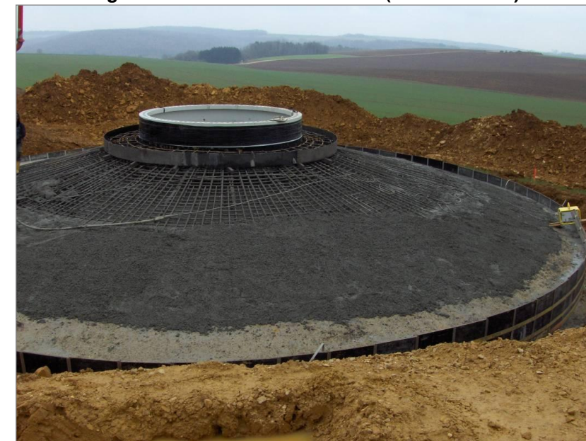
Figure 13 : Exemple de ferrailage en radier pour une éolienne (chantier en cours, source Vestas)
